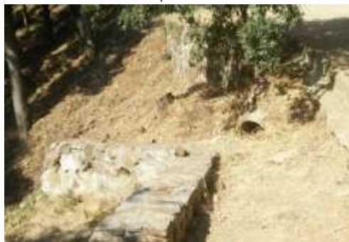
Murets difusors existents que no funcionen correctament.
