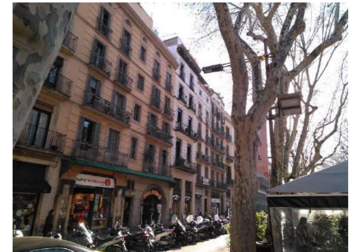
Connexió de cablejat aeri entre façanes i lluminàries en zones de terrasses, La Rambla, 56
