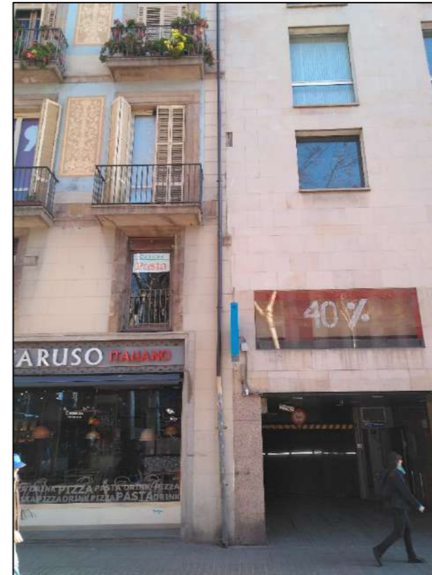
Pas de la xarxa de telecomunicacions de soterrada a aèria en façana, La Rambla 96
