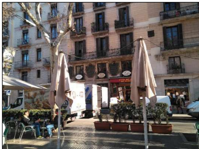
Connexió de cablejat aeri entre Terrasses i Luminàries, Rambla 76
