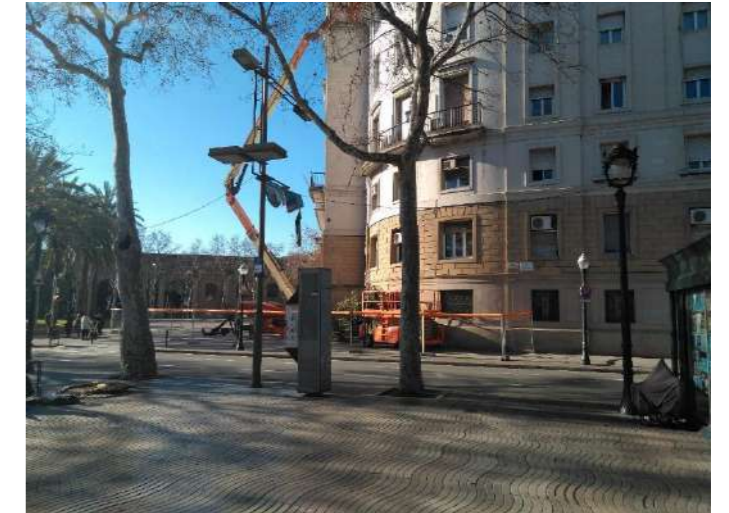
Connexions de cablejat aeri entre lluminàries, la Rambla 5-7
