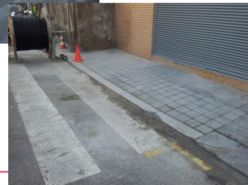
Estat després de l'actuació
