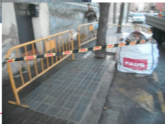
Estat després de l'actuació
