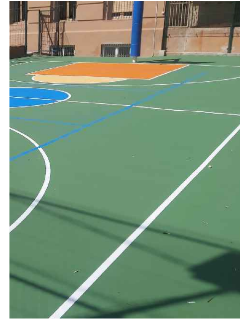
5_FRESAT I COL·LOCACIÓ DE NOU PAVIMENT DE RESINES AMB ÀREES I LÍNIES PINTADES
