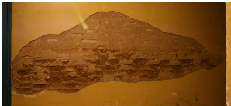
2. Bombament i caiguda del revestiment a la paret mitgera
