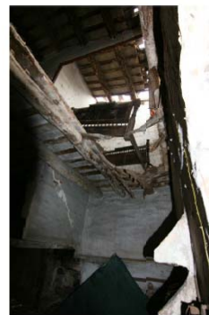
2. Esfondrament del sostre de planta balsa
