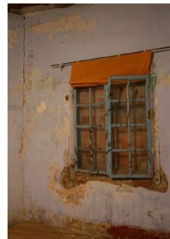
33. Despreniments i esquerdes de la façana nord
