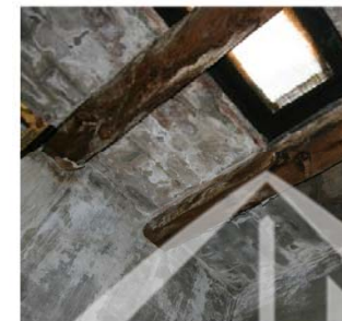
28. Humitats per filtracions de la coberta al badalot de l'escala
