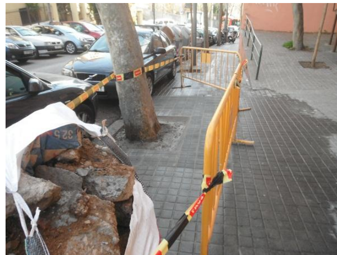
Estat després de l'actuació
