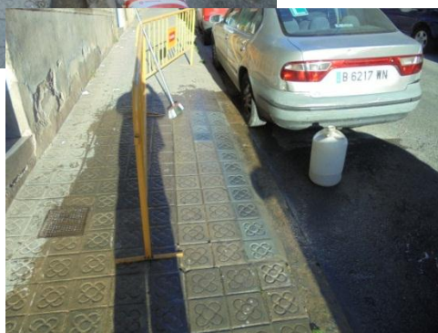
Estat després de l'actuació
