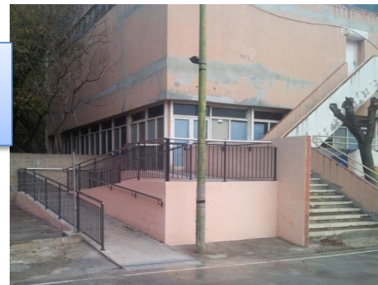
Estat després de l'actuació
