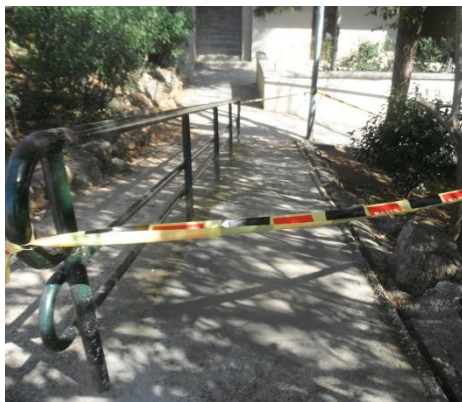
Estat després de l'actuació
