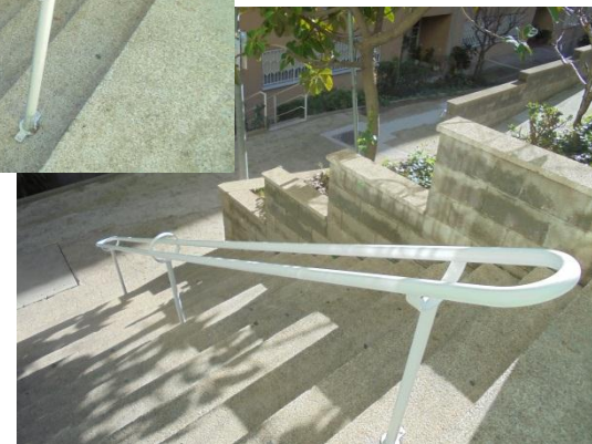
Estat després de l'actuació
