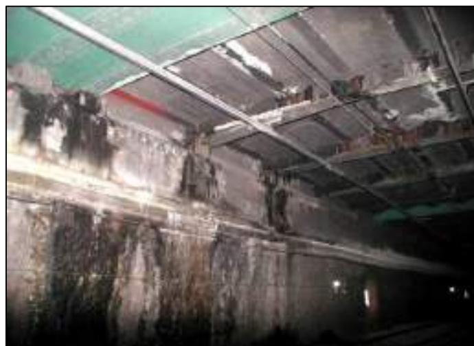
Imatge de les filtracions al túnel de metro de línia 3, a La Rambla
