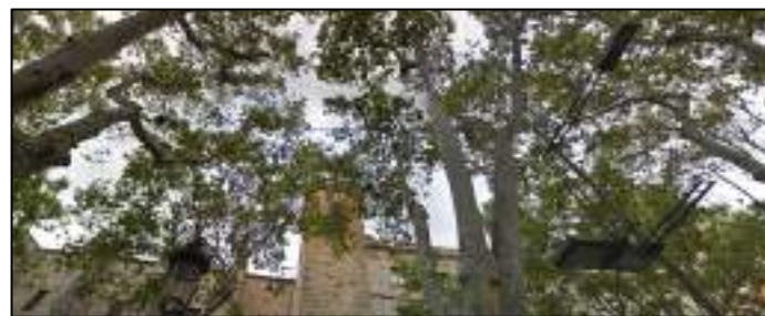
Connexions de cablejat aeri entre lluminàries, vista des de la calçada nord de La Rambla dels Estudis
