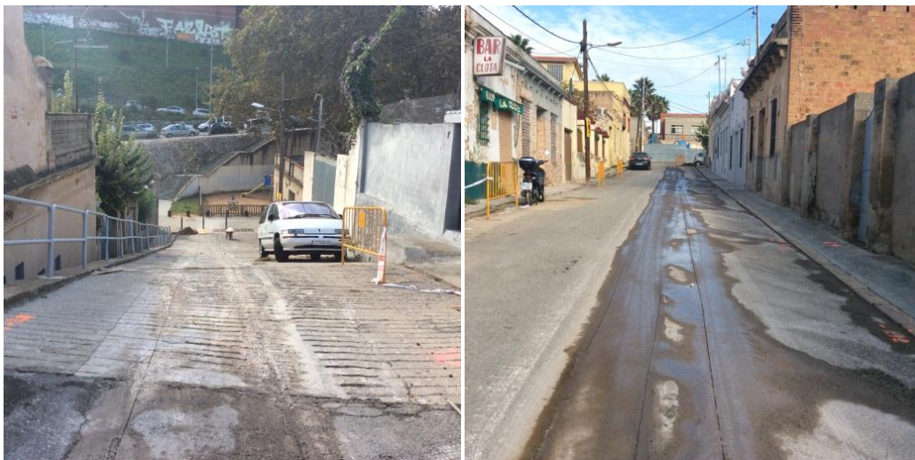
Estat abans de l'actuació
