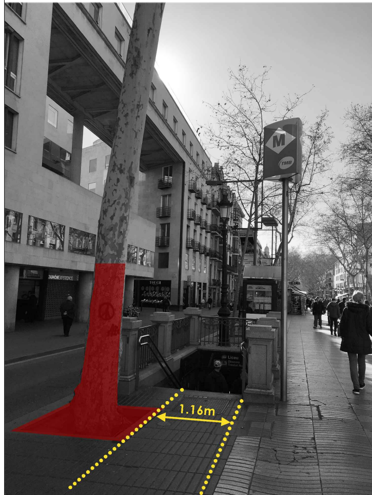
A5_Accés Metro Liceu (Problemes d'accessibilitat_accés metro)
