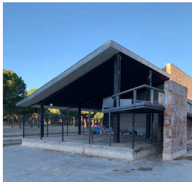
Situació amb la tanca vandalitzada
