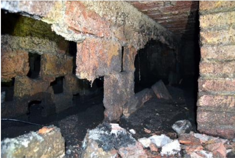
FORJATS SANITARIS DETERIORATS
