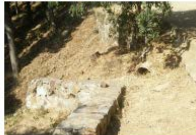
Murets difusos existents que no funcionen correctament.
