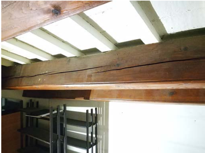
Clivelles i fenedures a les bigues
