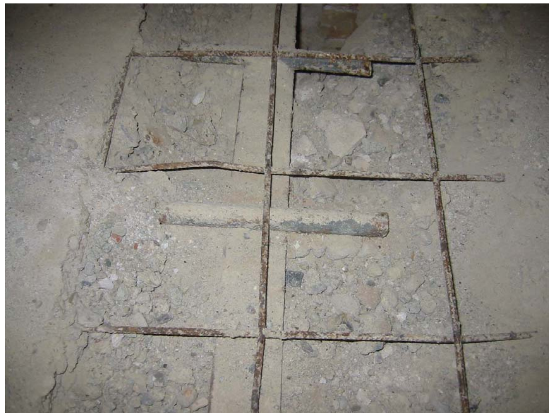
Fotografia 4- Capa de compressió 1Ø5c/15 connectada amb 1Ø20c/26 longitud 20cm soldat a perfil -reforma 1984
